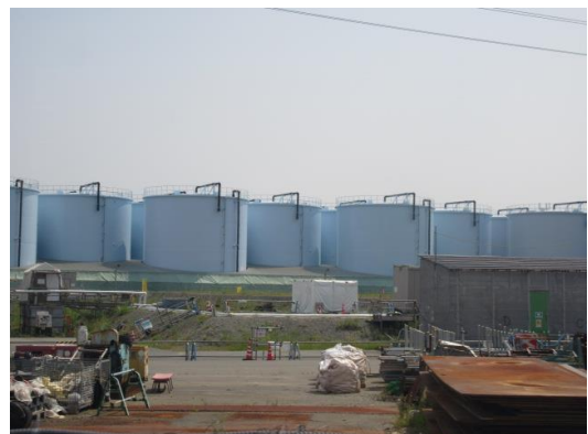
発電所構内で汚染水を保管するタンク群
