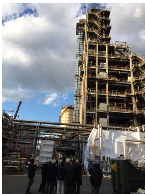
廃プラスチックのガス化装置
